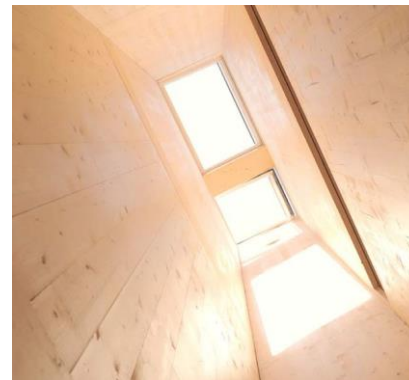
Zonneshoorsteen met daklicht
