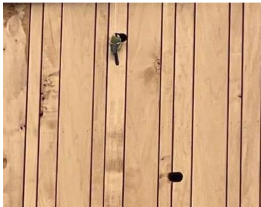
Voorzieningen voor vogels in de gevel
